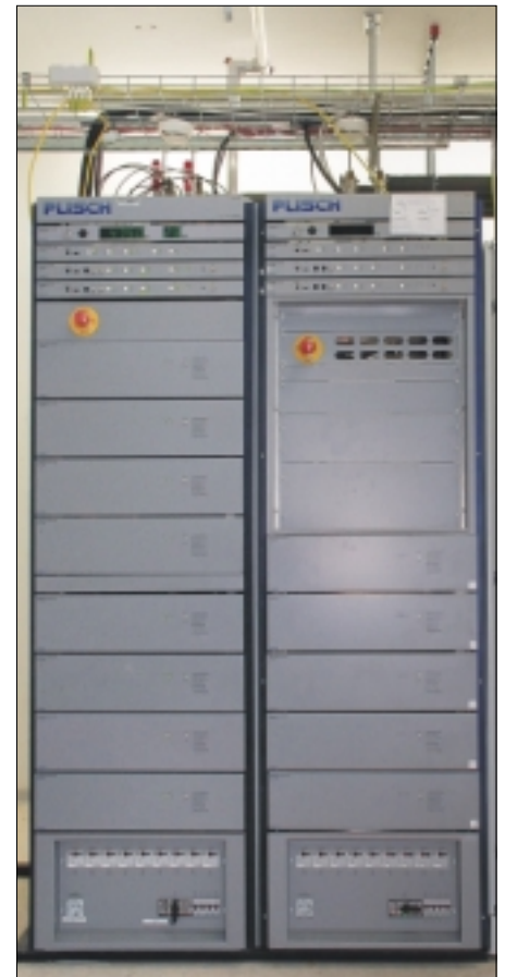
Zwei Sender für DAB+ in der Sendestelle Ittersberg bei Weimar, der ersten Sendestelle für DAB+ in Thüringen; Aufnahme vom November 2011.
