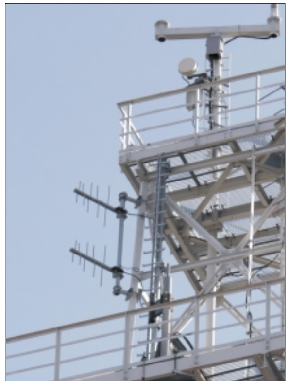
Logperiodics am Funkturm Erfurt-Hochheim, Inbetriebnahme Dezember 2020.
