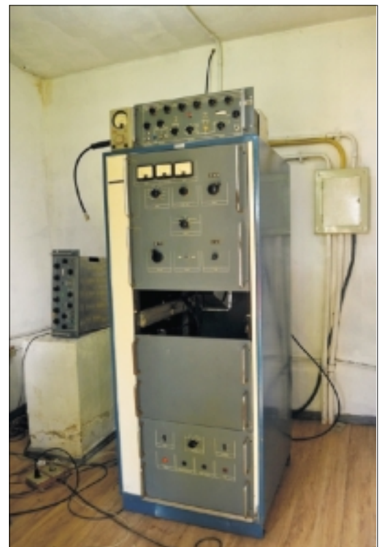
Über diesen Kurzwellensender der Firma Redifon Telecommunications wird das offizielle Zeitzeichen Brasiliens auf 10 KHz ausgestrahlt.
