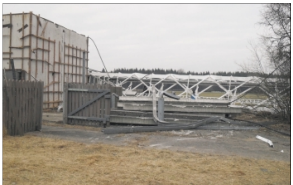
Der gefallene Mast.
