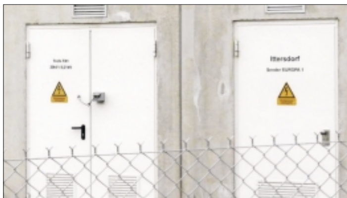
Transformatorzellen des Senders Felsberg, auch für die Sonderspannung 210 Volt von TRAM-Sendern.
