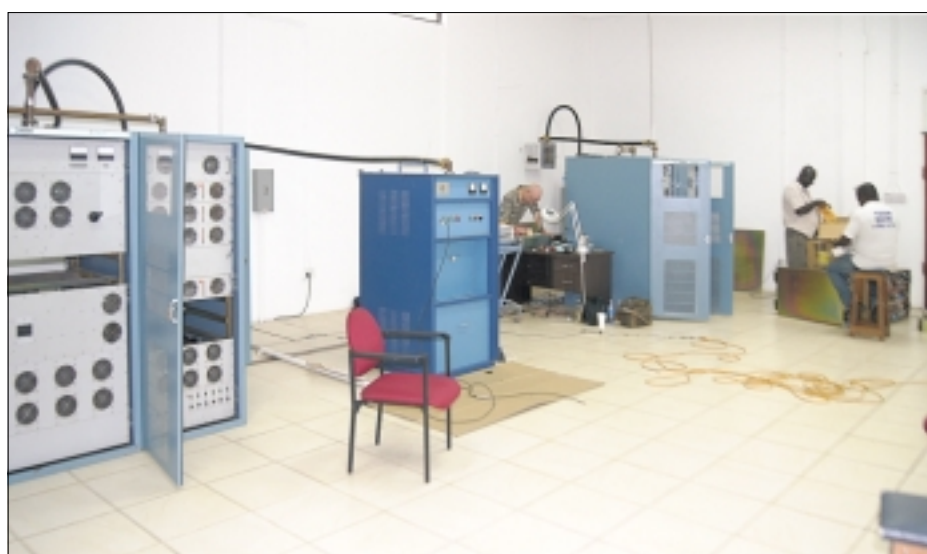
Der AM-Sendersaal in Georgetown; links der Betriebssender 20 kW und in der Mitte der Reservesender 5 kW für die Mittelwelle 560 kHz, rechts der 10 kW starke Sender für die Kurzwelle 3290 kHz; im Bild Jamie Labadia bei der Reparatur eines Verstärkermoduls.
