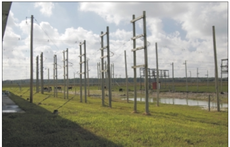
Großzügig: Die umfangreiche Antennenfarm.
