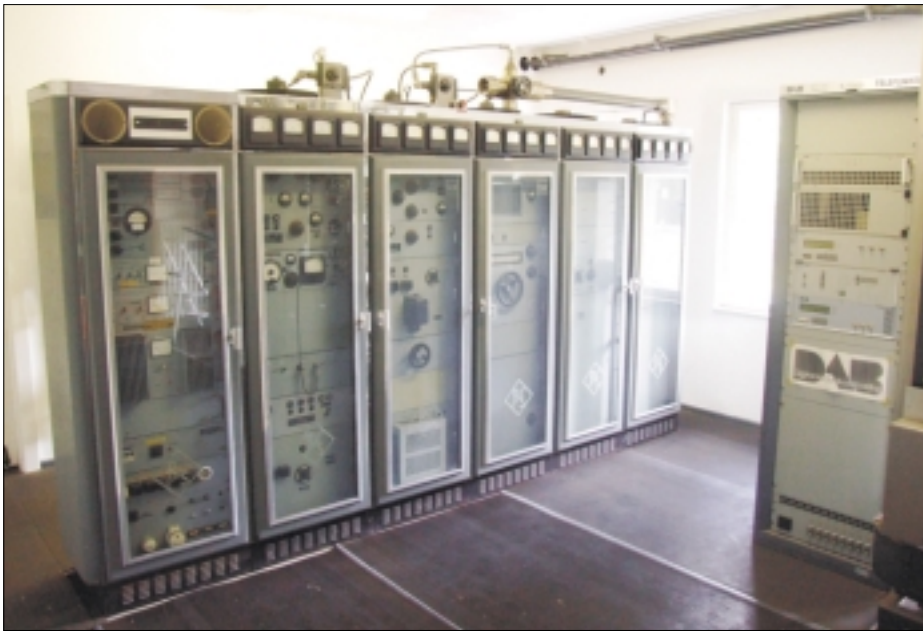
1957 installierter, 10 kW starker UKW-Sender der Firma Rohde & Schwarz, daneben einer der Sender, mit denen ab 1995 zeitweise im Gleichwellenbetrieb mit anderen Standorten DAB-Signale aus Berlin-Britz abgestrahlt wurden.
