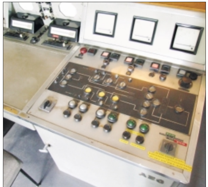
Auch nach dem endgültigen Ausfall des Kurzwellensenders von 1951 sind die Leuchttaster auf dessen Bedienpult noch nicht erloschen. Man beachte auch den hier mit angeordneten Ein-/Aus-schalter für den 1957 installierten UKW-Sender.
