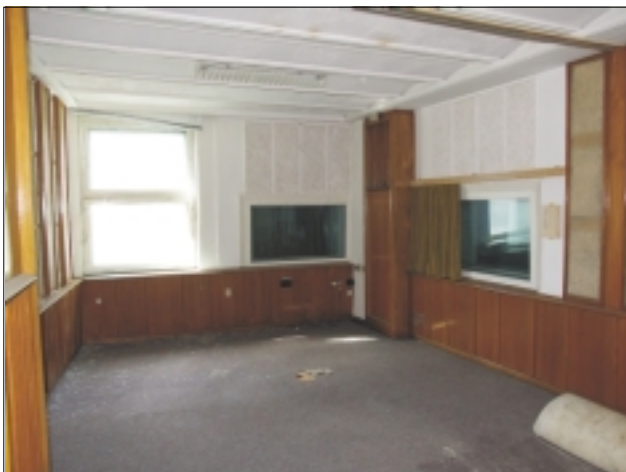
Sprecherraum des Sendekomplexes K 1, in dem von 1991 bis 1993 auch die Sendung 'DX Aktuell' produziert wurde.
