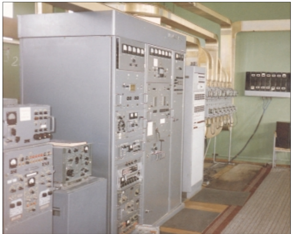
Abbildung 4: Sendeanlage für Jamming im Laitse-Sendezentrum in Tallinn.
