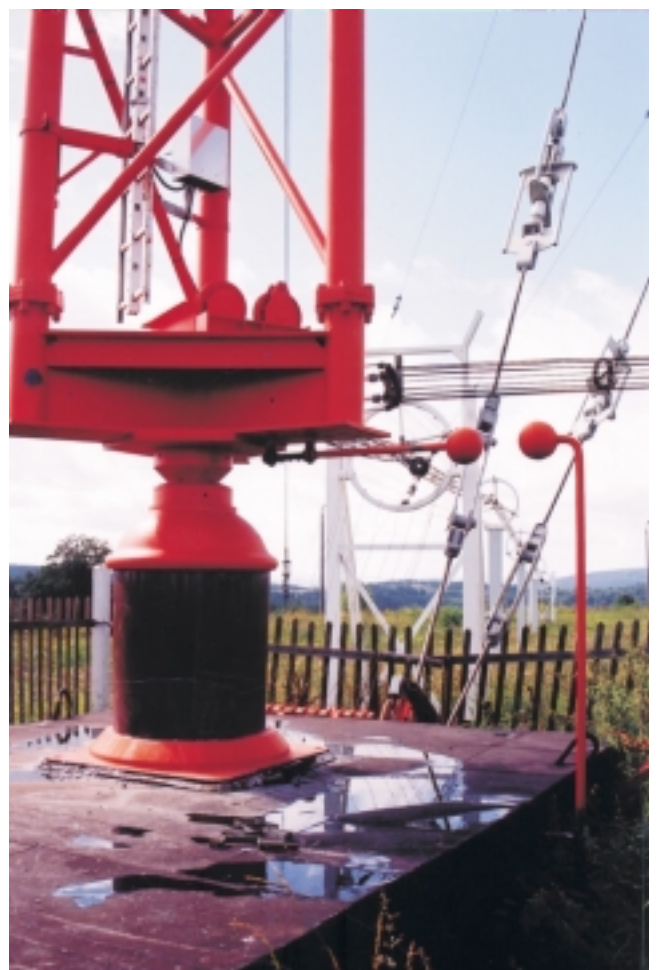
Isolierter Mastfuß mit Funkenstrecke
