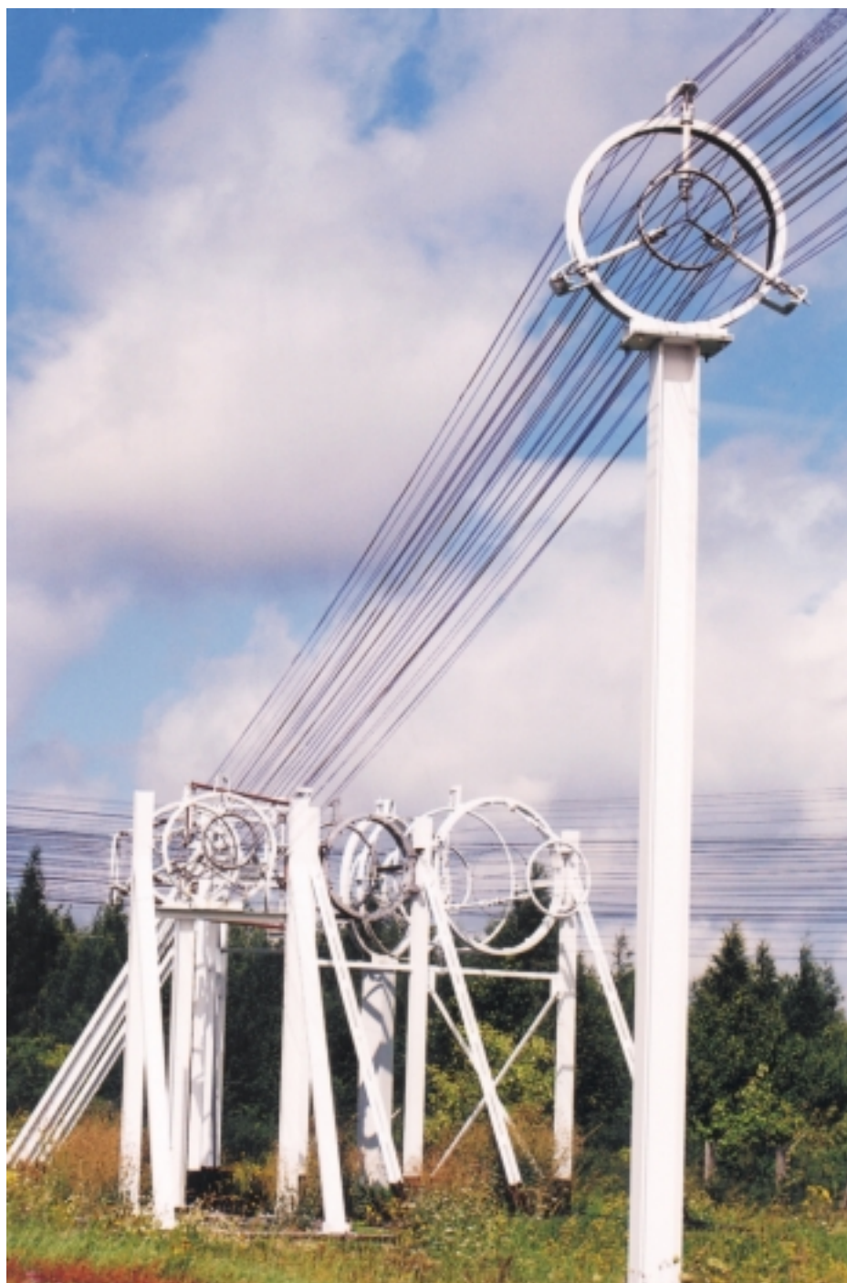
In diesen Knotenpunkt mündet die Stichleitung zur Antennenanpassung (von rechts kommend)
