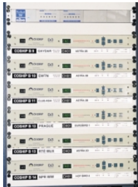
Einige der Monitorempfänger, die von WRN aufgeschaltete Satellitenstationen kontrollieren
