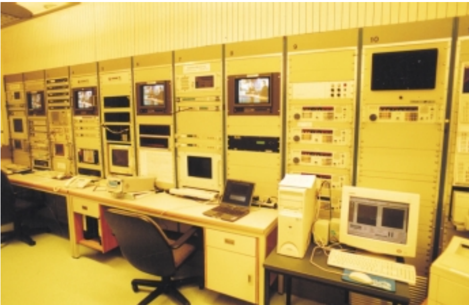
DW-Monitor-Station Bockhaken: Blick auf die Satellitenüberwachung. In der Ecke rechts Computerterminal zu Messzwecken der DRM-Versuchssendungen. Foto: Silken Medert
