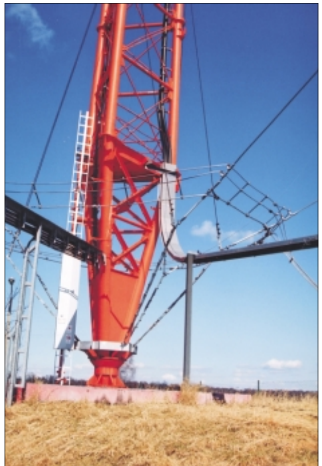
Mastfuß in Zehlendorf. Foto: Gerhard Roleder.
