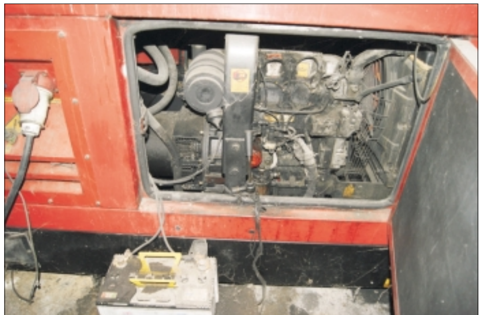
Der typische Zustand eines Notstromgenerators.
