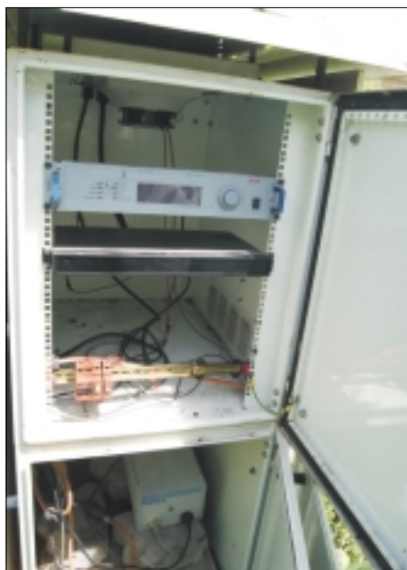
Der Senderschrank der Station Baucau.
