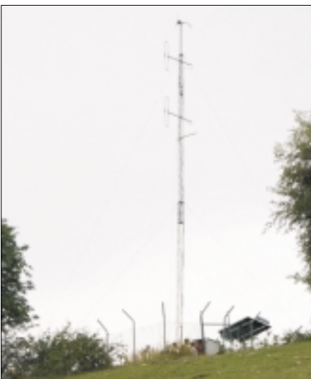
Die ferngesteuerte Senderanlage in Oecussi mit Windgenerator und Solarpanel. Die 800 MHz Yagi Studiolinkantenne sieht man unterhalb der Hauptantennen.
