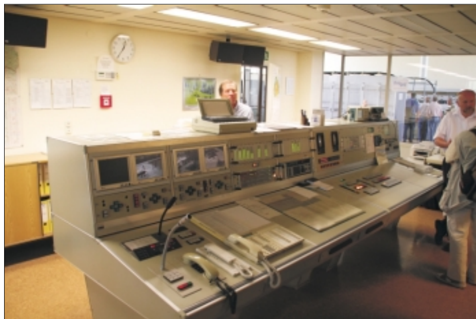
Zentrale Schaltwarte des Bayerischen Rundfunks in Ismaning.
