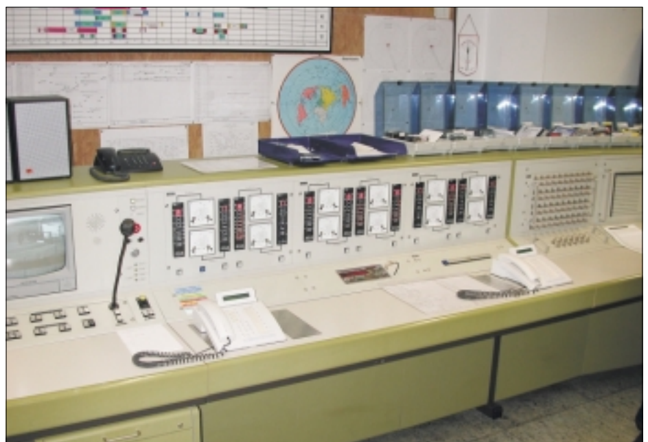
Pult im zentralen Steuerraum des Sendezentrums Jülich. Foto: Bernhard Weiskopf.
